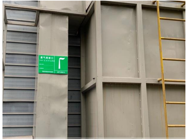
2#喷漆废气排气装置
