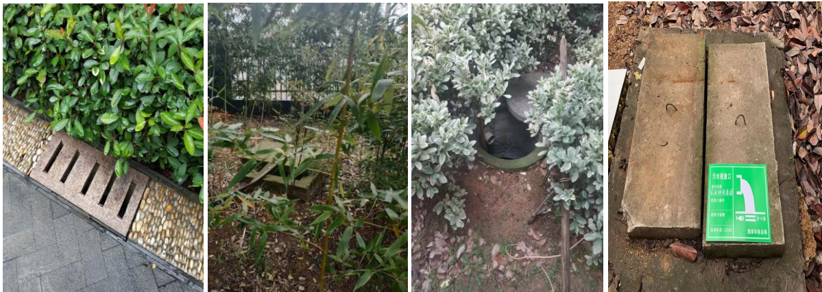
厂区雨水收集管网
