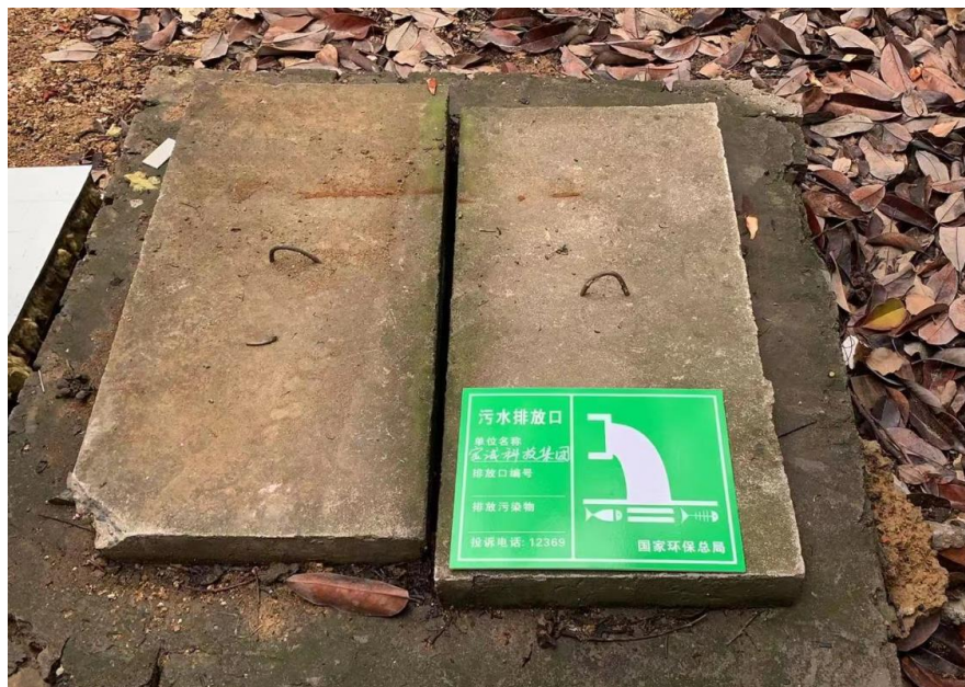
污水总排放口
